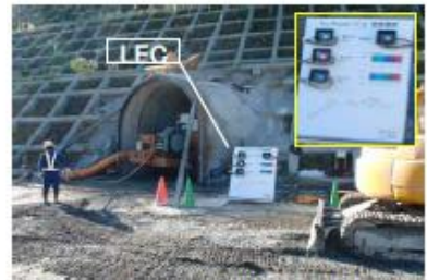
トンネル坑口部のLEC設置状況
